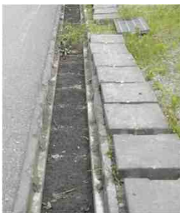
側溝に堆積した土砂
