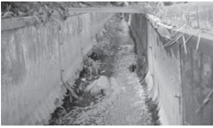
腐食の激しい山田水路、早期の改修が待たれる
