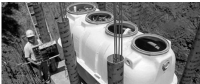
合併処理浄化槽
