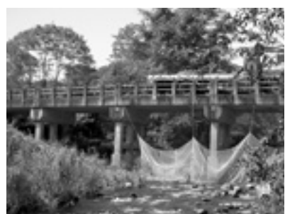
老朽化した木端橋
