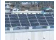
太陽光発電設備 ソーラーパネル
