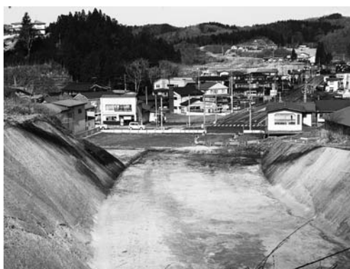
地域と地域を結ぶ市道の整備を進めます(写真は千厩地域の国道456号と284号を結ぶ市道石堂構井田線)
