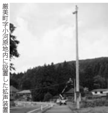
厳美町字小河原地内に設置した拡声装置
